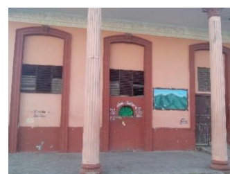
UBE, panadería El Turquino. Presenta roturas de varios días con frecuencia, como la que tiene actualmente.
