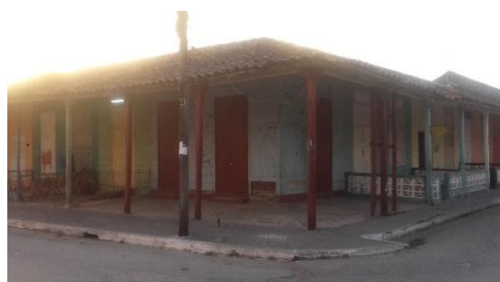
Una verdadera calamidad constructiva. Así de sencillo.
