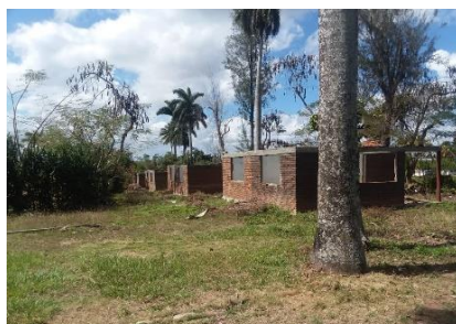
Habitaciones no terminadas o en reparación por tiempo indefinido.
