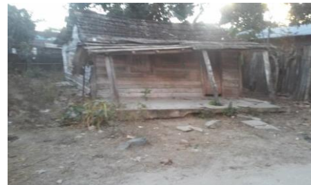
Ranchería en pésimo estado del poblado
